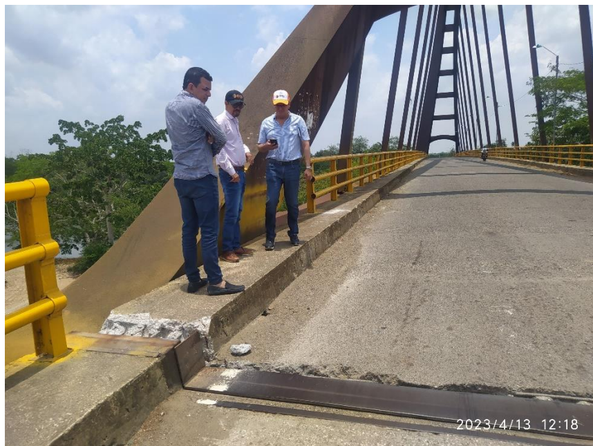
Se observa la falta de secciones de baranda metálica
