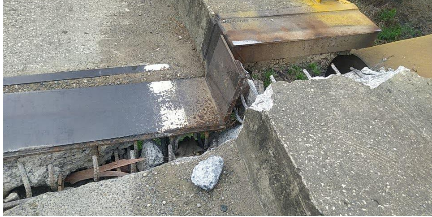
Detalle de la afectación por deterioro del concreto y pérdida de un tramo de junta sobre el andén peatonal
