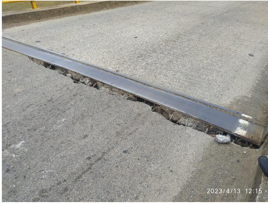
Vista general de la junta de dilatación deteriorada
