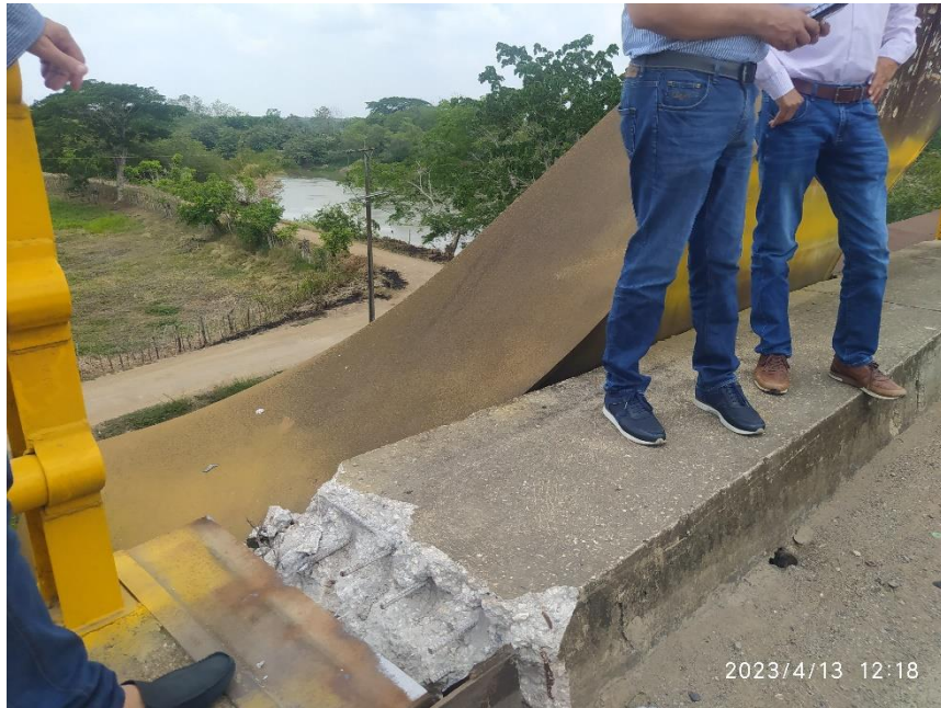
Afectación del andén peatonal
